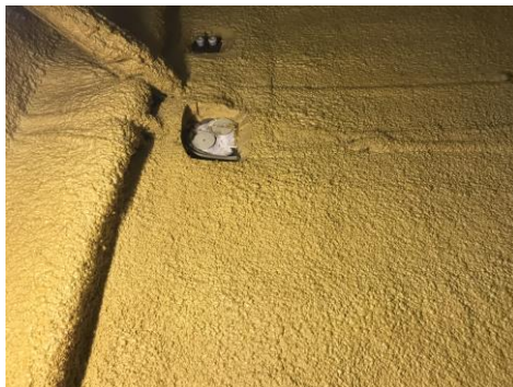
Der gelbe PU-Schaum mit verbauter Verteilerdose im Dachstuhl St. Petrus Canisus
